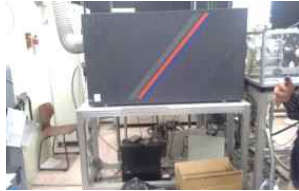
사용시설 감지기 설치 누락
