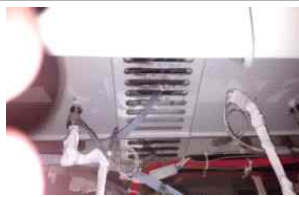
가스흡입구 상부 필터 막힘, 음압형성 장애
